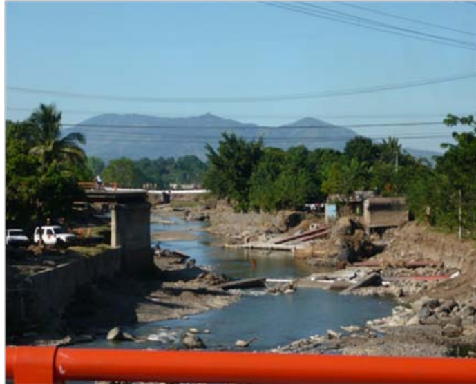
Figura 3-9:Puente destruido entre San José, Costa Rica y Puerto Caldera
