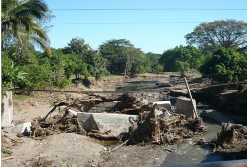
Figura 3-11: Puente ferrocarril destruido, se observa línea férrea colgando. Carretera entre Puerto Acajutla y San Salvador
